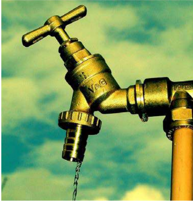
Fuga de agua. Fuente: ( https://pixabay.com/es/photos/fontaner%C3%ADa-el-agua-tuber%C3%ADa-1002110/ )
