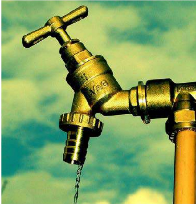
Fuga de agua. Fuente: ( https://pixabay.com/es/photos/fontaner%C3%ADa-el-agua-tuber%C3%ADa-1002110/ )
